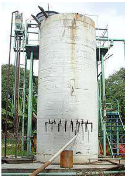
Figura 8 – Foto de biodigestor do tipo RAFA
